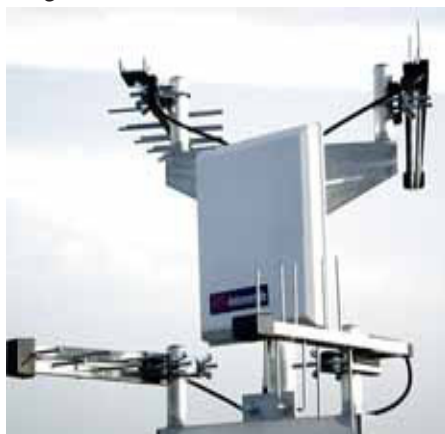
Beispiel einer LTE-Antenne mit MiMO
