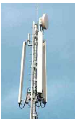
typische Mobilfunkbasisstation mit drei Sektorantennen und Richtfunk
