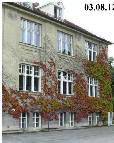
Nordfassade, freie Sicht zur Sendeanlage Eichamt Messung: 4.980 \mu\text{W}/\text{m}^2
